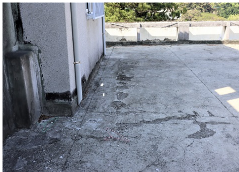
2. 屋頂防水層破碎化
